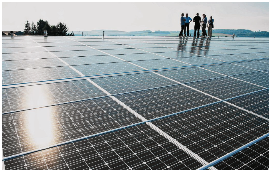
Derzeit sucht Optima Solar Freiburg-Freiburg nach geeigneten Dächern für die Installation von Fotovoltaikanlagen.
